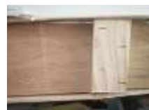
Figura 16 Desplazamiento relativo piezas de madera reutilizada
